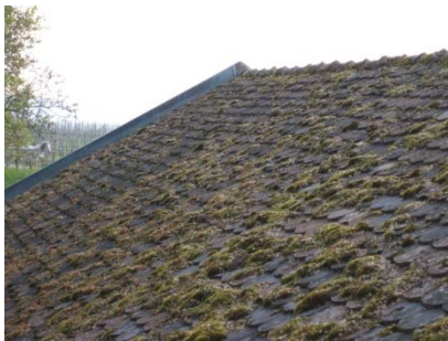
Vorher, Moos und Laub bestimmen das Dach
